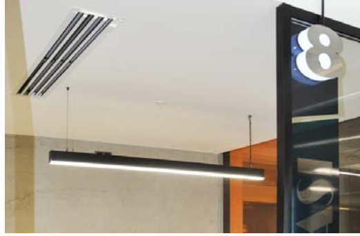
Görsel 12. Ofis alanları aydınlatma elemanı ve havalandırma ünitesi
