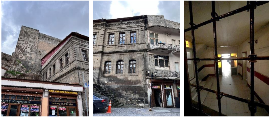
Görsel 12. Tarihî binaya sonradan eklenen kaçak yapılar: Güney cephesi, kuzey cephesi ve kuzey cephedeki binanın içine açılan pencere detayı
